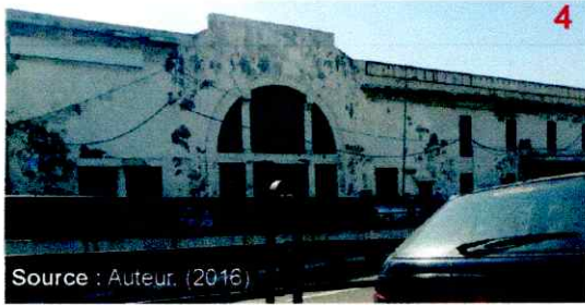
Figure 35 : Photo d'un hangar désaffecté.
