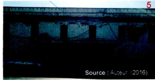
Figure 36 : Photo d'un hangar désaffecté.
