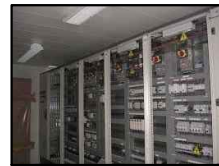
fig:48 locaux technique.
