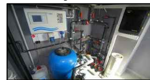
fig:49 locaux technique.
