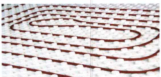
Fig09 Plancher chauffant / rafraîchissant
