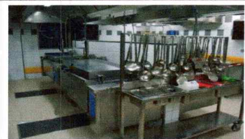
Fig 25 Equipement de cuisine
