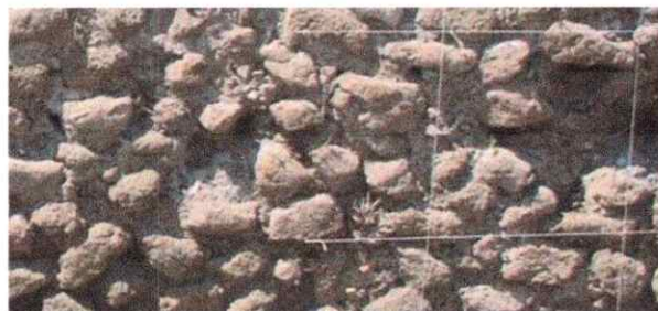
Figure 37 : L'appareil incertain, source : archéologie construction romain
