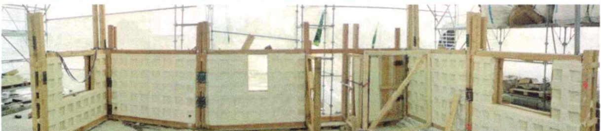
Figure 62 : Photo panoramique des murs connectés et placés sur le site à Troyes. source : Journal of Space Structures
