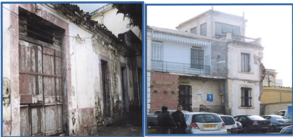
Fig.12 : La dégradation du bâti constituant le noyau colonial
