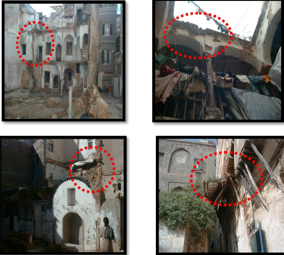
Photo. 13 : L'état des maisons du quartier Amar Ali de la Casbah d'Alger.
