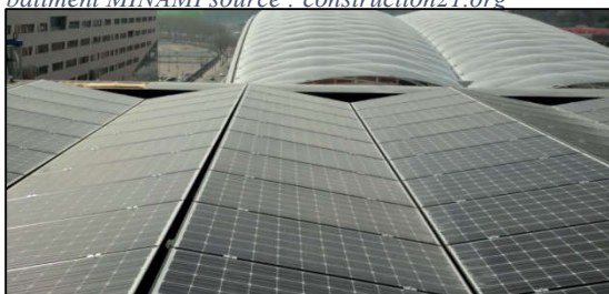
Figure 38: Panneaux photovoltaïques posés sur la toiture du bâtiment source : Google image
