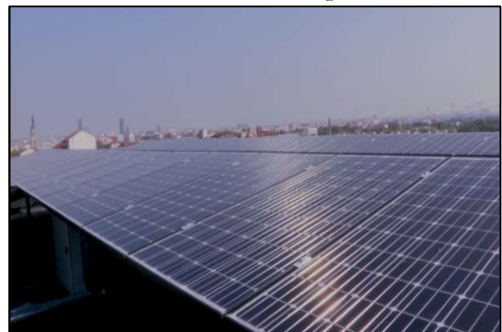
Figure 37: Panneaux photovoltaïques sur le toit du bâtiment source : Google image
