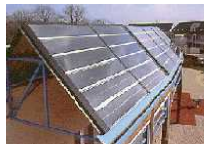
Figure 21: Les capteurs solaires thermiques Source: Liébard et DE Herde, 2005
