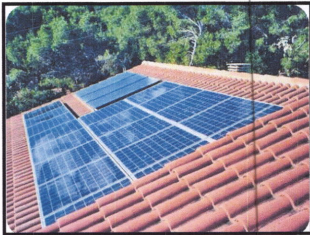
figure 30: les panneaux solaires
