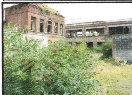
Photo.3 : ETAT D'DEGRADATION DU CENTRE-VILLE ROUBAIX Source : Google images
