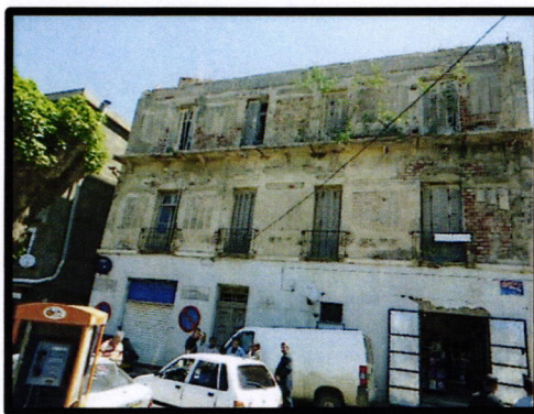
Figure 26 : Dégradation du cadre bâti dans le noyau historique
