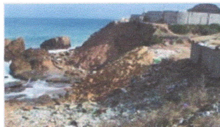
Figure75: état des falaises en dégradation.
