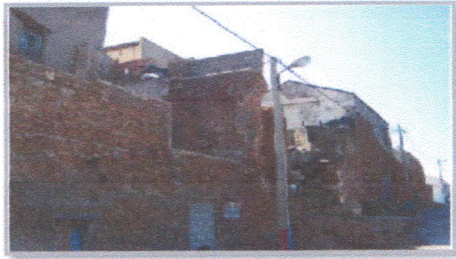
Figure50: dégradation de la façade maritime Nord-est du centre ville.
