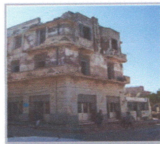
Figure45 : Dégradation et abandon des immeubles dans le centre ville.
