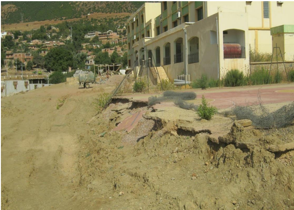
Figure II.8 : la niche d'arrachement (zone 1)
