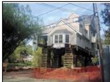
Figure 77. Réhaussement des habitations source : www.norfolk/city.com
