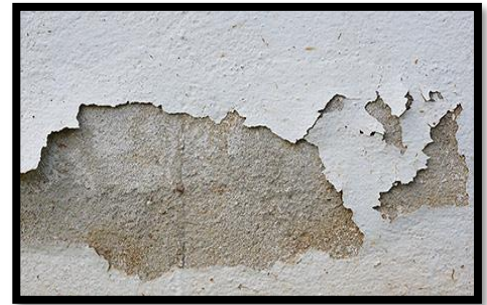
Fig.1.71 : Impacte de l'humidité sur les murs. Source : des thèses
