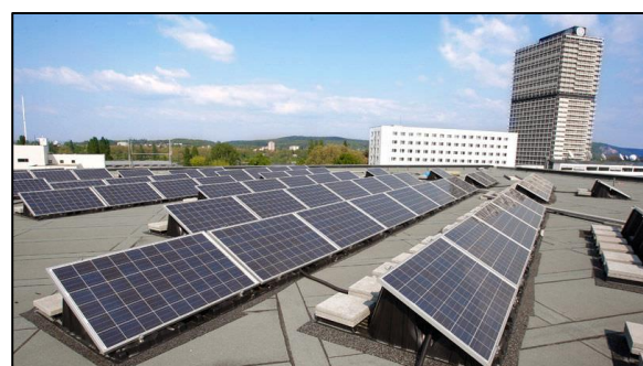
Figure II-34: panneaux solaires sur toit plat (source : Google image )
