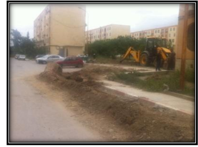
Figure 3.44 Photo de la cité en chantier, réseau défectueux
