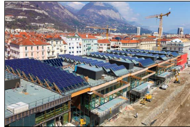
Figure 26 (3.3.5.1) : Centrale photovoltaïque en toiture de l'espace commercial. Source: Grenoble : ville durable. La ZAC de Bonne, un ÉcoQuartier en centre-ville , 2010, p. 14.
