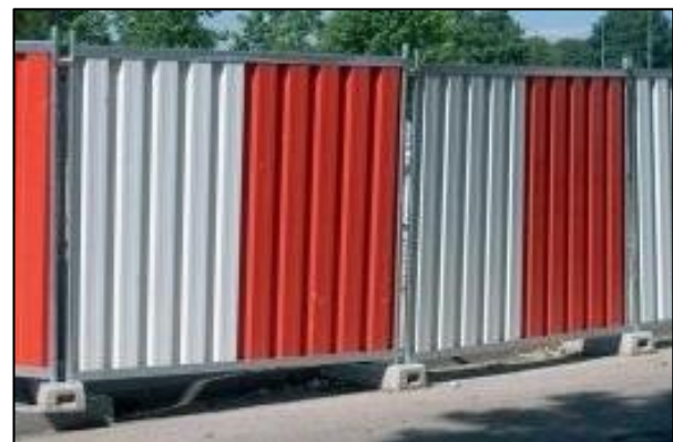
Figure 107 (3.1.2.2) : clôture de chantier à panneaux fermés. Source: Consultée le 10/09/2017 à l'adresse : http://www.loxam-module.com/vente/produit/cloture-opaque-avec-plots
