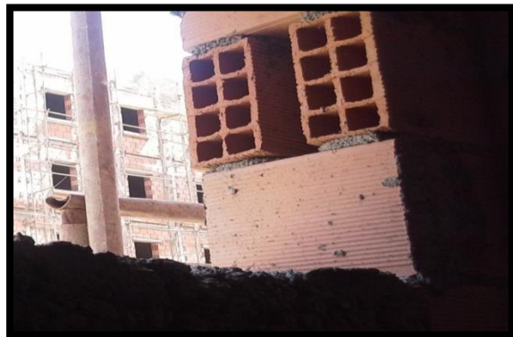
Figure 11: Photo sur un mur extérieur.
