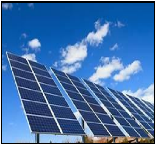
Figure 58 : Présente des panneaux photovoltaïques. Source : https://images.search.yahoo.com
