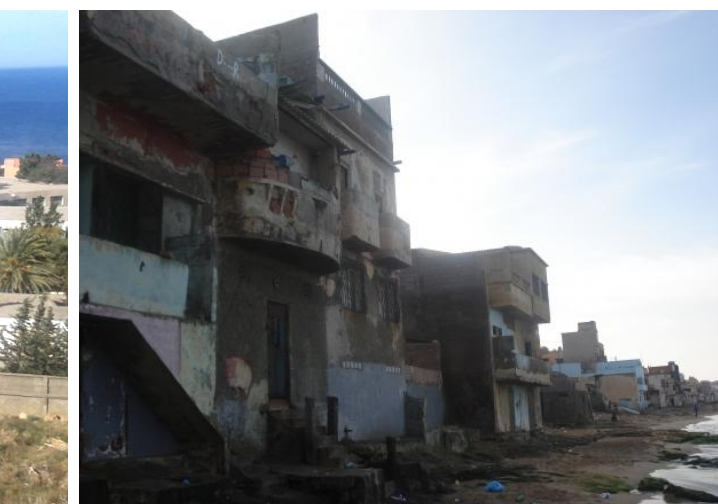
Bâti dégradé Alger (Source) : googleusercontent.com
