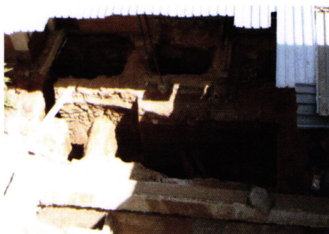
Image 22 Canalisations traversant les bassins et les remises des écuries en contre bas.
