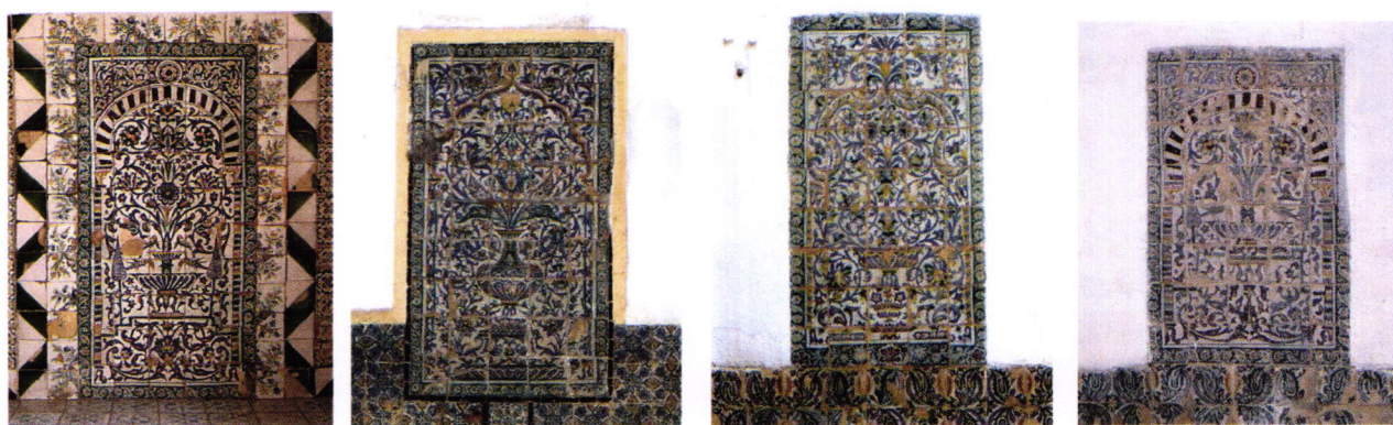
Image 56 Etat de conservation des panneaux de faïences exposées aux intempéries.
