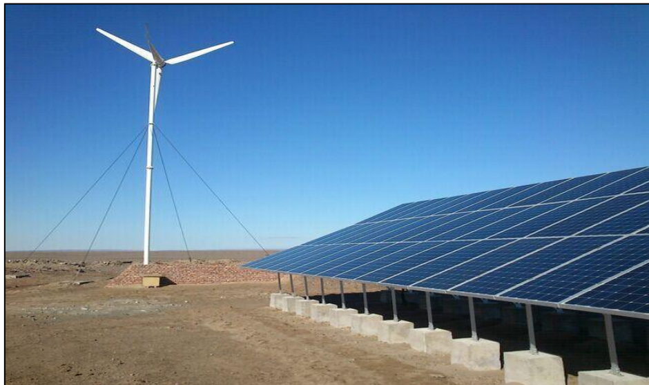
Figure 2-2: Système hybride (éolienne-panneaux photovoltaïques)
