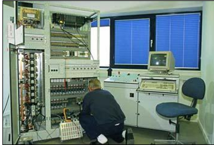
Figure 2-18:salle de contrôle
