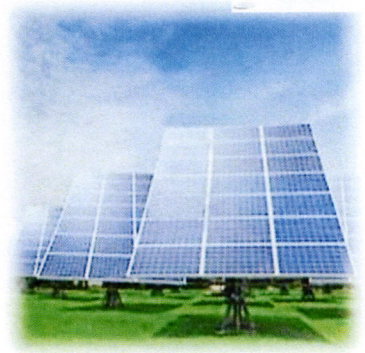
Les énergies renouvelables (éolien et le solaire)
