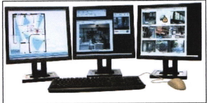
Figure 159 : Moniteurs de surveillances ; source : google image.
