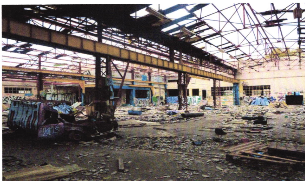
Figure 2.2 : Friche industrielle d'une usine à l'abandon dans les environs de Toulon en France
