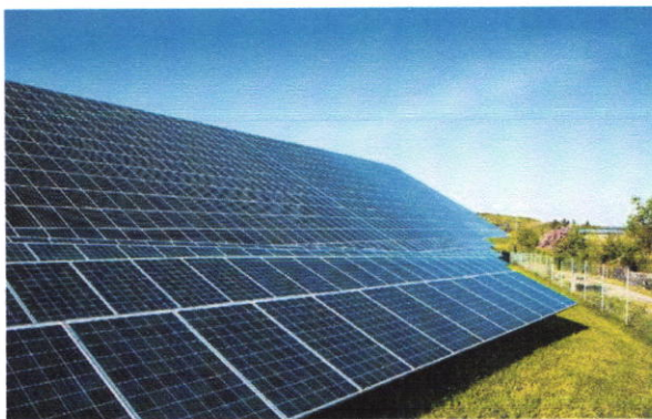
Figure: photo de panneau solaire Source :www.archimedia.ma
