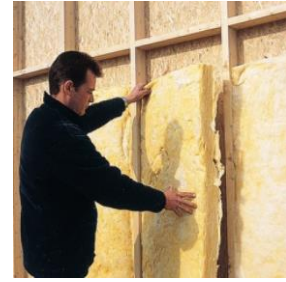
Photo : la laine de verre à l'extérieure Source : Site web
