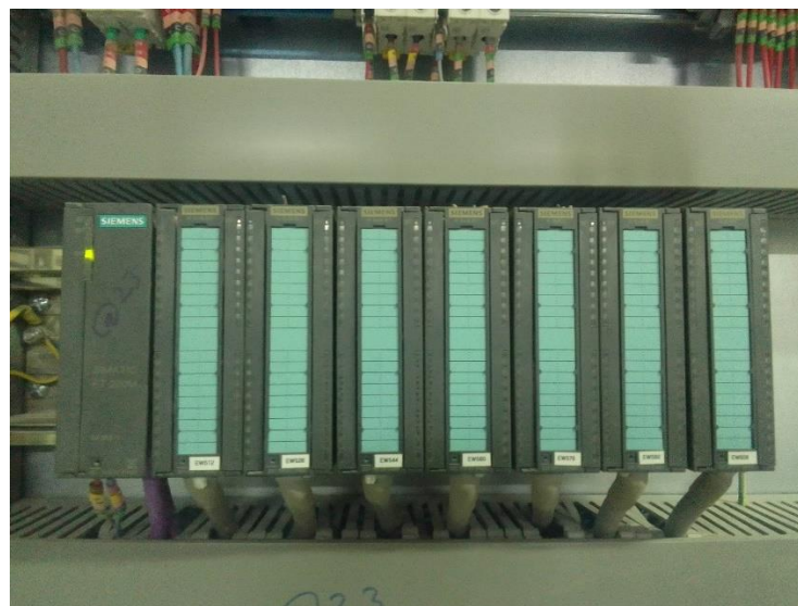
Figure 2.14 : Image de station ET 200
