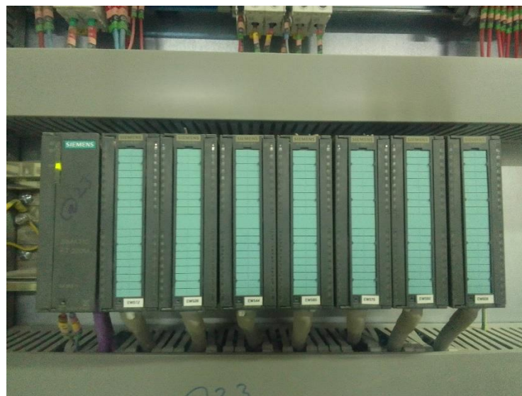
Figure 2.14 : Image de station ET 200
