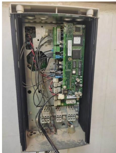
Figure 3.24 : Câblage Variateur de vitesse
