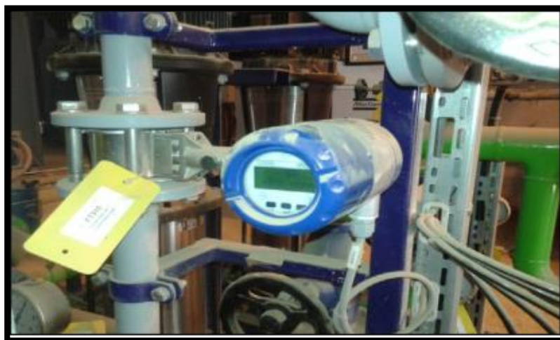
Figure 2.12 : Débitmètre Vortex KROHNE
