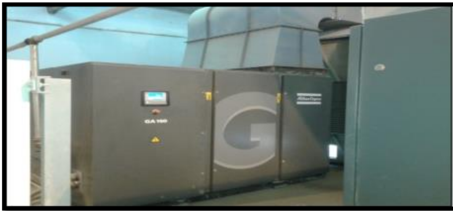
Figure 2.2 : compresseur d'air Atlas Copco GA 160
