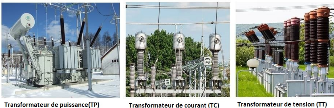
FIGURE 1.19 – Différents types de transformateurs sont utilisés dans les postes électriques.
