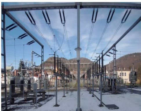
FIGURE 1.20 – Les jeux de barres à HT 110kV.
