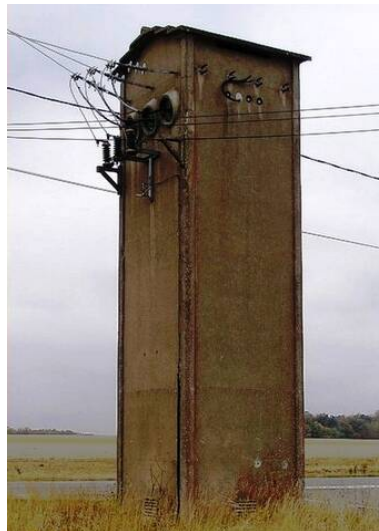
FIGURE 1.16 – Le poste de transformation de haute tension (HTA).
