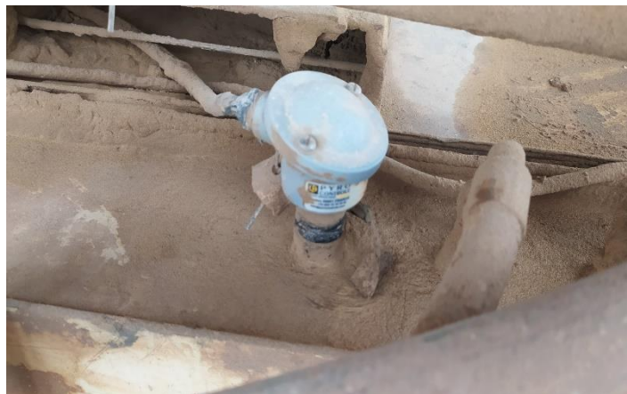
Figure 2.5 : Niveau réservoir huile
