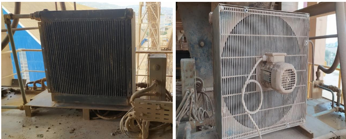
Figure 2.3 : Ventilateur refroidissement huile du CENTREX
