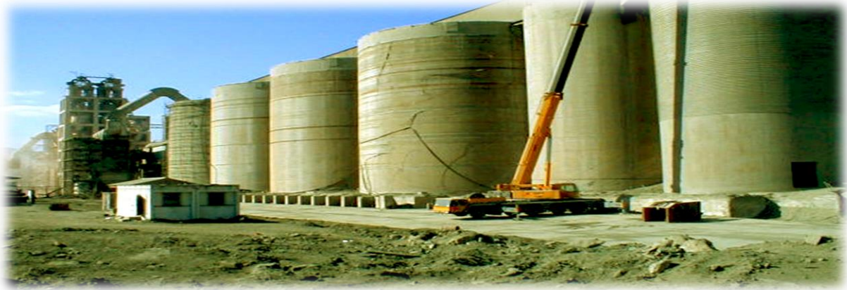
Figure 1.16 : Silos de Stockage de Clinker
