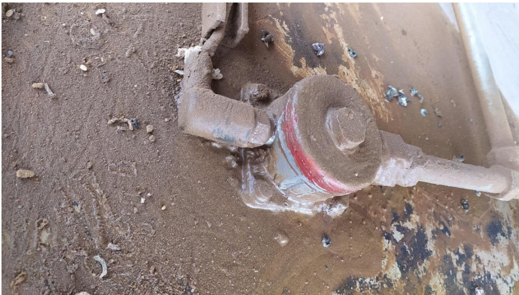
Figure 2.6: Colmatage filtre à huile pompe hydraulique
