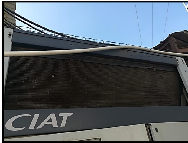
Figure 2.7 : condenseur a air
