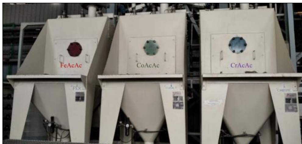
Figure II.14 : Les Bacs de Stockage Pneumatique.
