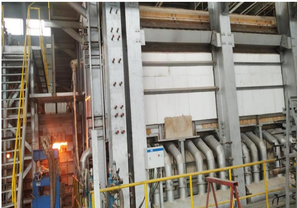
Figure II.4 : Une partie du four régénérateur.
