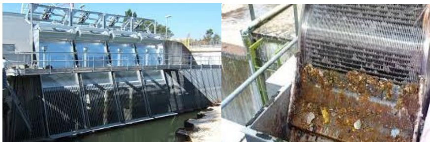
Figure 1-1: Un dégrilleur pour le prétraitement des eaux polluées.
