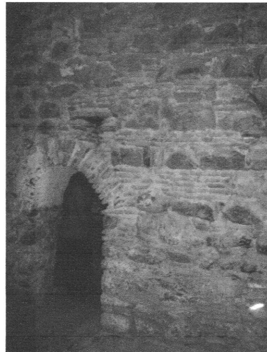
Figure 52 : Mur en briques avec moellons. 75
