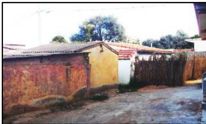
Figure3.63: bâti en mauvais état Source : photo prise sur terrain
