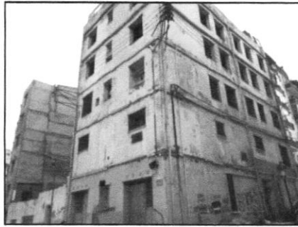
FIG I.08 : Immeuble vétuste (ilot du Dey) Source : auteur, 2018
