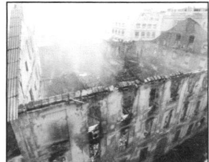
FIG I.09 : Immeuble ravagé par l'incendie (ilot du Dey) Source : www.libertie-algerie.com
