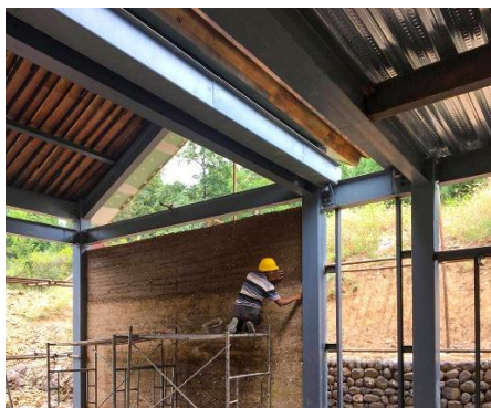
Figure 67 : Photo montrant l'état du mur ancien. Source : Arch Daily.
