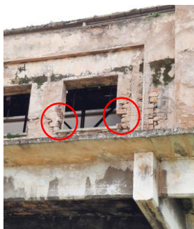
Figure 96 : Dégradation des arrêtes de finition « Source : Auteur »
