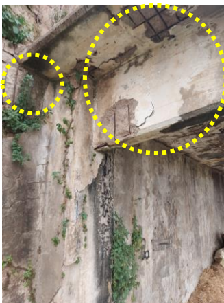
Figure 111 : Corrosion du béton + Apparition des armatures « Source : Auteur »
