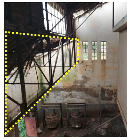
Figure 113 : Profilé métallique rouillée « Source : Auteur »
