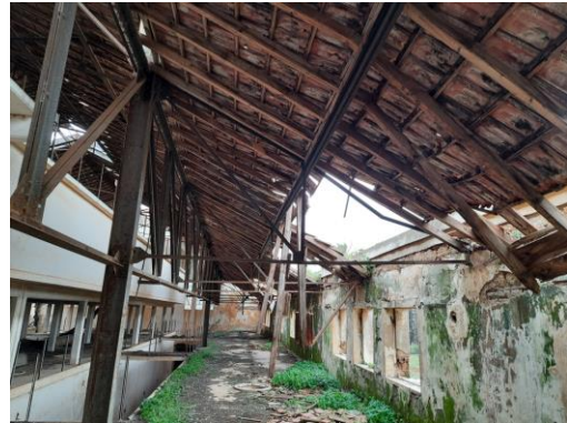
Figure 104 : Détérioration de l'élément Joint / Gouttière « Source : Auteur »
