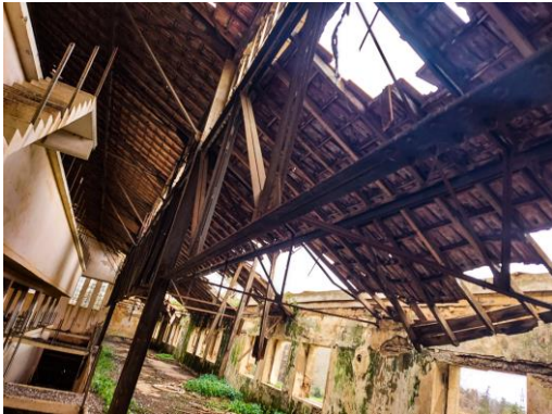
Figure 103 : Effondrement de certaines parties de toitures « Source : Auteur »
