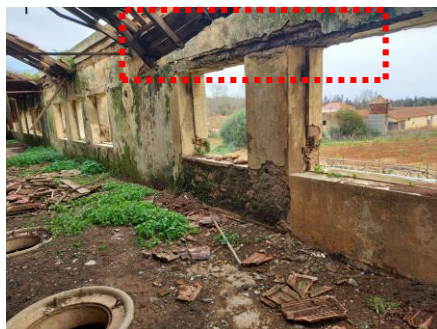
Figure 97 : Fissure et dégradation des linteaux « Source : Auteur »
