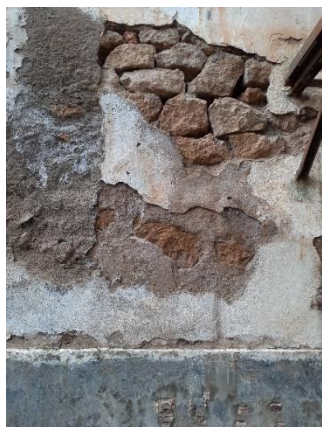
Figure 91 : Dégradation de la couche extérieurs « Source : Auteur »
