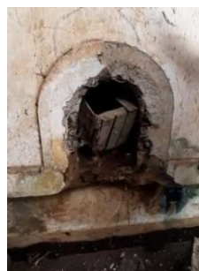
Figure 115 : Cadres en cuivre blanc des cuves volés « Source : Auteur »
