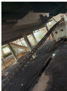
Figure 118 : Morceau de la vis d'Archimède « Source : Auteur »
