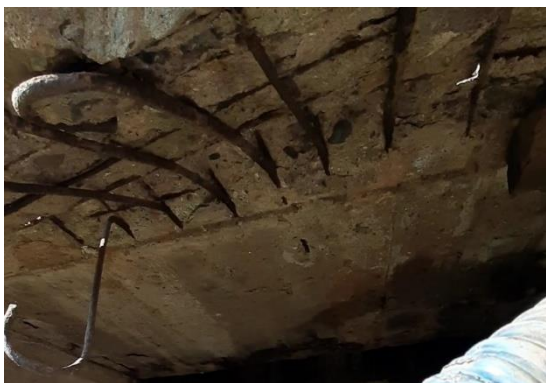
Figure 68 : Vue de dessous de la dalle pleine de la sulfaterie « Source : Auteur »
