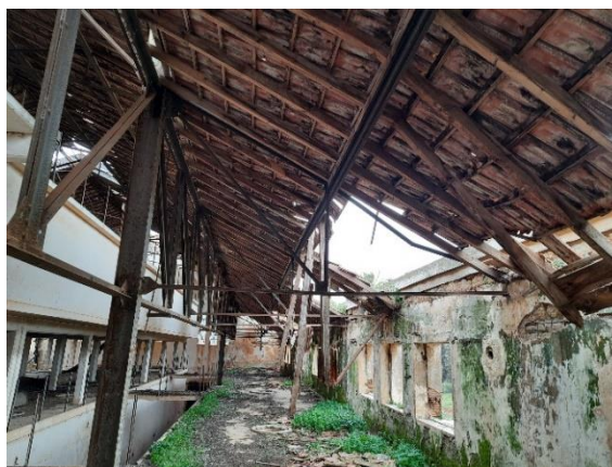
Figures 54 : La partie latérale de la charpente métallique de la cave coopérative « Source : Auteur »
