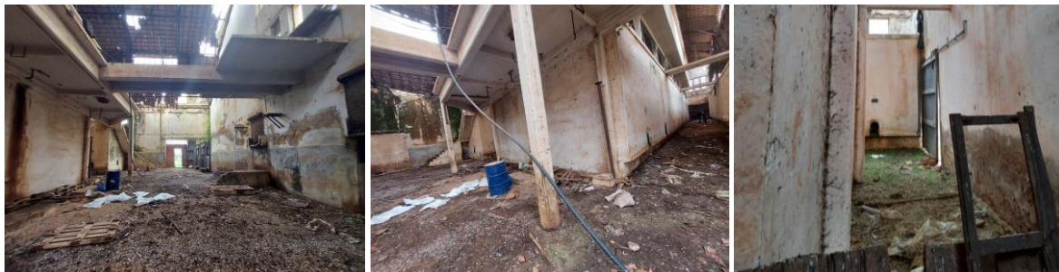
Figures 88 ; 89 ; 90 : Etat actuel du sol de la cave coopérative « Source : Auteur »
