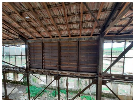
Figure 100 : Volets rouillés des clairevoies « Source : Auteur »
