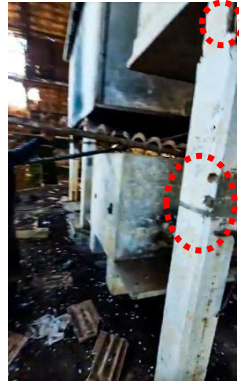
Figure 109 : Poteau interne endommagé « Source : Auteur »
