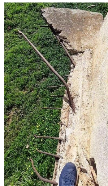
Figure 67 : Vue de dessus de la dalle pleine de la sulfaterie « Source : Auteur »
