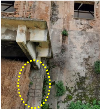
Figure 108 : Corrosion du béton + Apparition des armatures « Source : Auteur »
