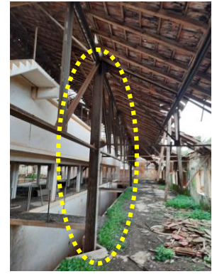
Figure 110 : Poteau métallique rouillé « Source : Auteur »
