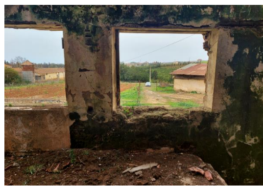
Figure 95 : Lichens sur les faces internes des parois « Source : Auteur »
