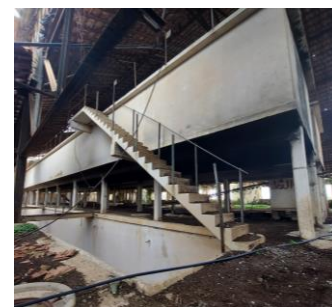
Figure 116 : Garde-corps des escaliers volés « Source : Auteur »
