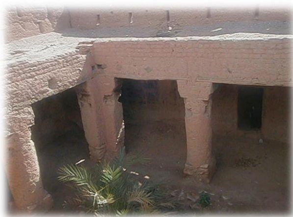
Figure II 16 : Wast Dâr d'el Qadi, à Boukais, dans la wilaya de Bèchar (2005) Source : Google image
