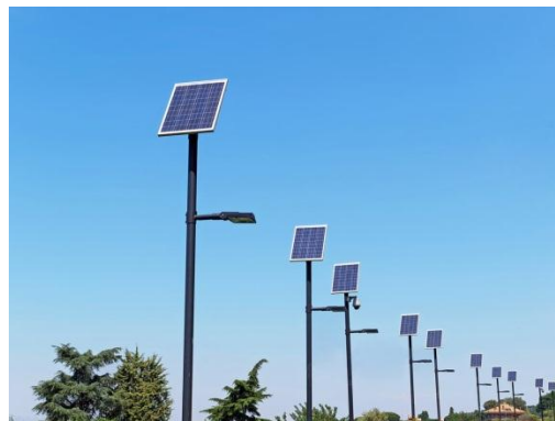
b) Lampadaire solaire
