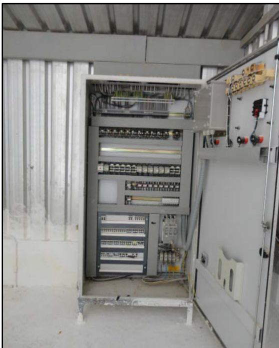
Figure N°07 : Armoire de commande.
