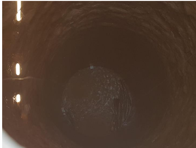
Puis capteur d'eau à l'intérieur de la palmeraie
