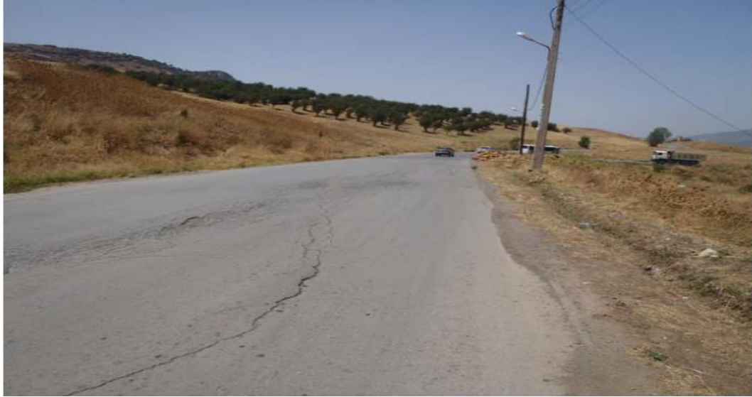
Figure II.7 : Fossés en terre (amont, aval) mal entretenus.
