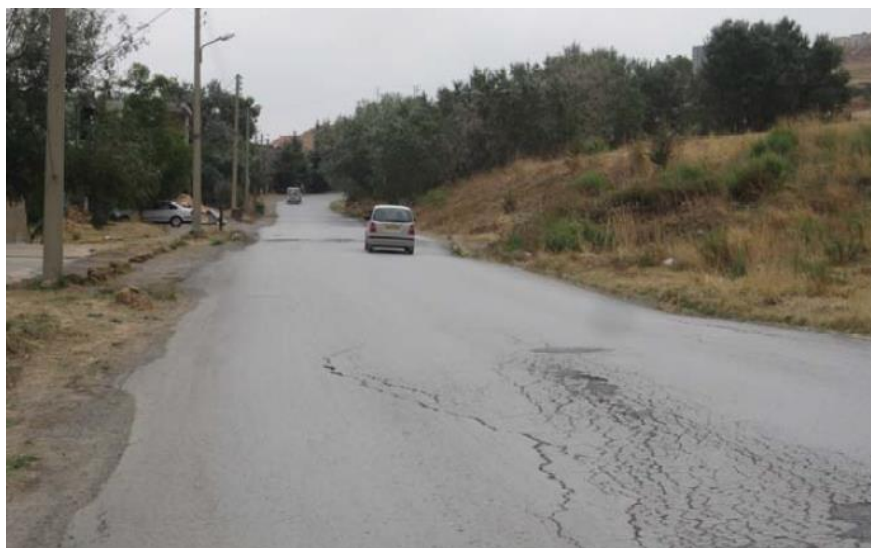
FigureII.3 : Fissures multiples, affaissement de chaussée.
