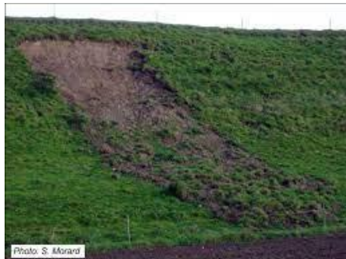
Figure I.6 .Glissement rotationnel en bordure d'une terrasse alluviale
