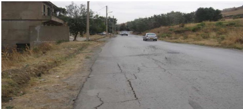
Figure II.2: Fissures multiples et affaissement de chaussée.
