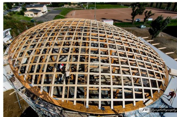
Figure 194 exemple structure en lamelle collé Le complexe culturel de Reyrieux. Source : https://arborescence-concept.com/projet/complexe-culturel-le-galet/
