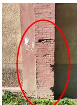
Figure 147: l'état du traitement de façade est
