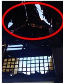
Figure 125 la toiture sous les 3 portes
