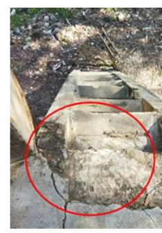
Figure 154: l'état de l'escalier de sulfaterie
