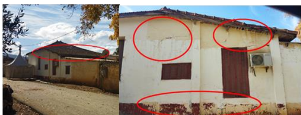
Figure 141: les désordres de la maison de maître
