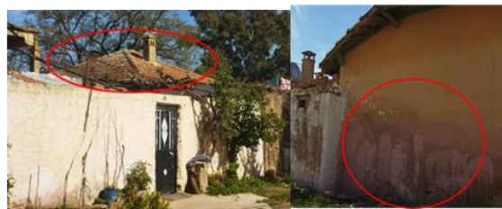
Figure 140: les désordres de la maison des ouvriers
