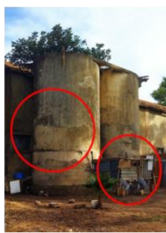
Figure 152: l'état du béton des silos
