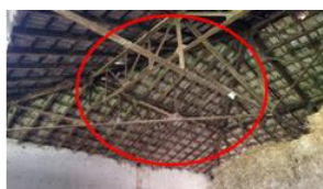
Figure 134: l'état de la structure métallique
