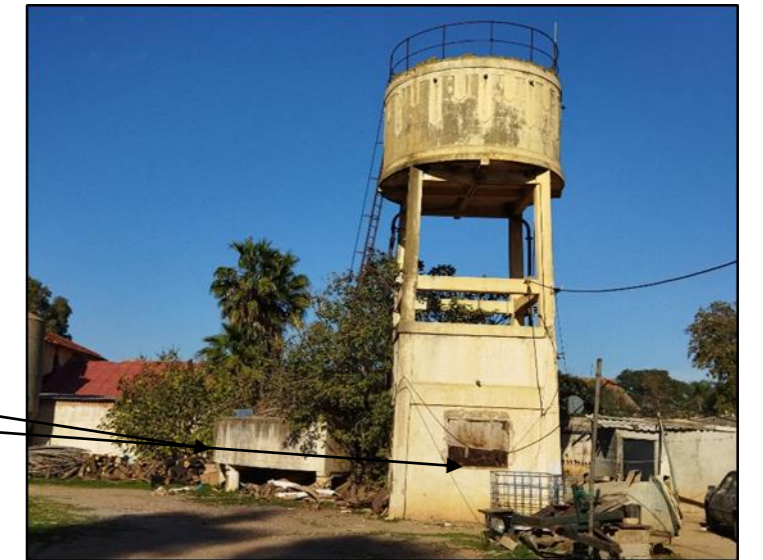
Figure 85: réservoir et château d'eau Source : Par l'auteur
