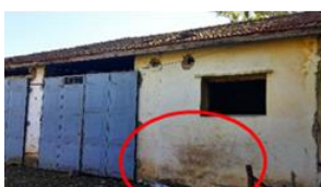
Figure 133: l'état de la peinture
