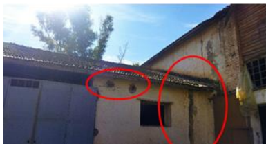
Figure 135: les désordres dans le mur sud
