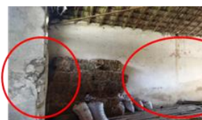
Figure 132: l'état des murs à l'intérieur
