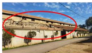
Figure 145: l'état de la toiture de l'annexe 01 et le mur extérieur
