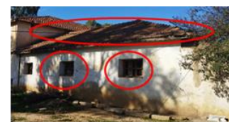
Figure 131: l'état de la toiture de côté nord et les ouvertures
