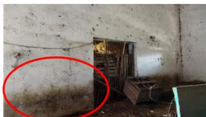
Figure 130: les traces de l'humidité
