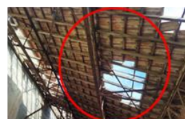
Figure 146: l'état de la toiture de l'annexe 02
