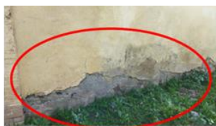
Figure 144: l'état des murs de la sud " la cave"
