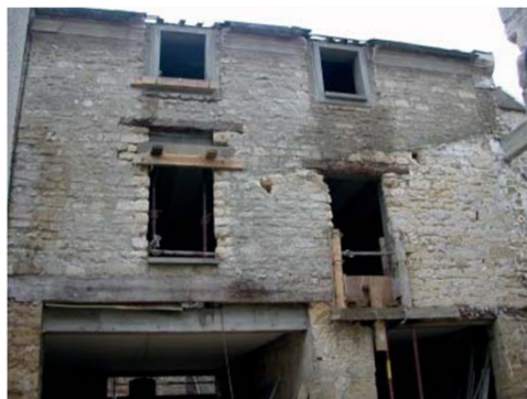
Vue sur la façade principale avec les poutres d'origine conservées et les nouveaux cadres en béton délimitant les percements.
