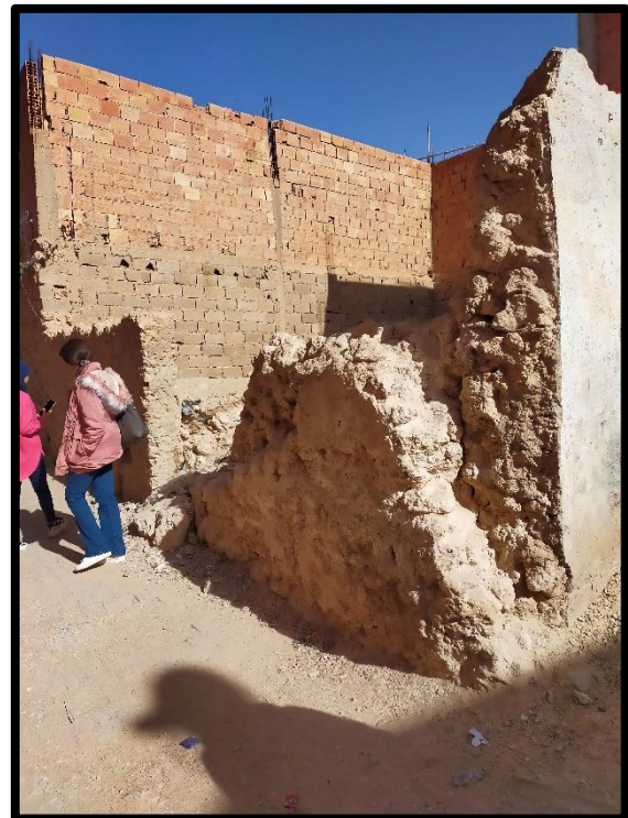
Figure 50 : une maison détruite à l'intérieur du ksar. Source : auteur.
