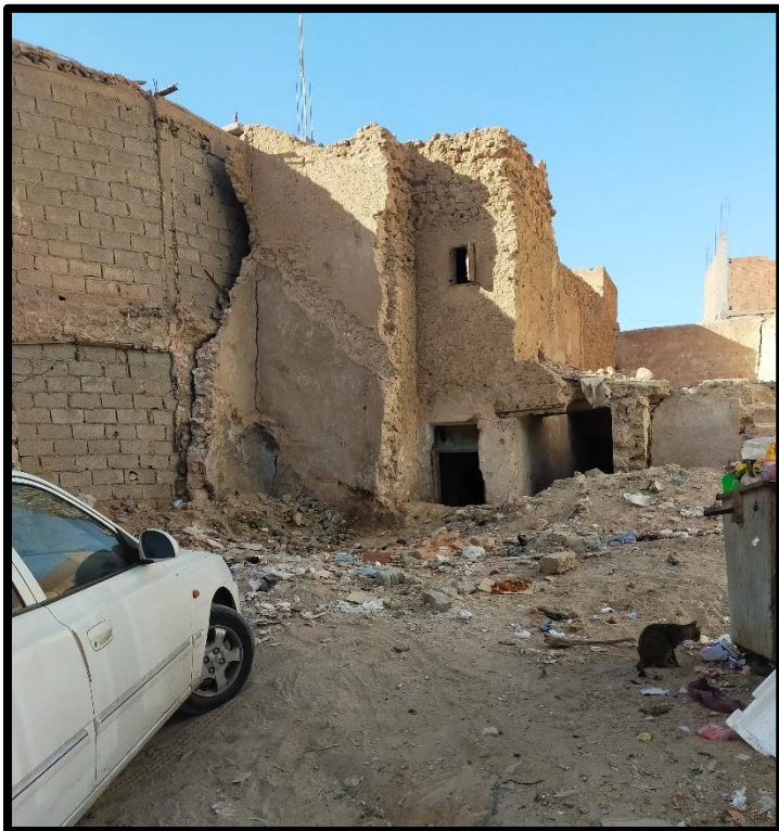
Figure 49 : une maison détruite à l'intérieur du ksar. Source : auteur.
