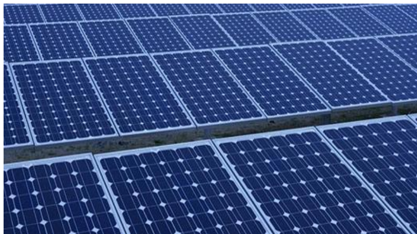
Figure I.12 : Panneaux solaires photovoltaïques
